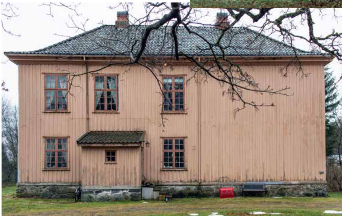
Under: Tilstand nordfasade.
